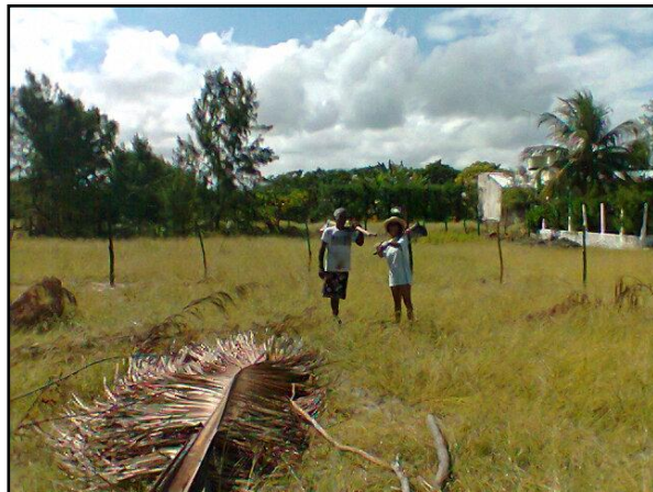
Imagem 01: Zé Carlos e a autora, depois de finalizar a colocação das estacas utilizando o cavador e a enxada, dando contorno ao terreno.
